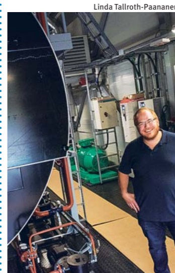
Jonas Asplund är nöjd med den nya reservpannan.
