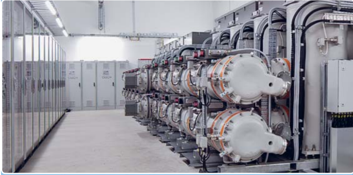
Kansikuva on Jussilan GIS-kytkentäaseman sisäpuolelta.
